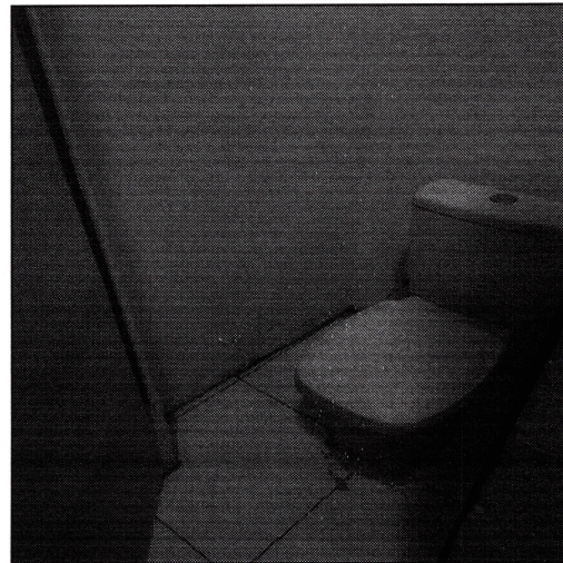
Imagem 10: Banheiro da escola, apenas com piso cerâmico.
